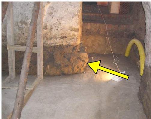
Obrázek 22.: Sklepní pilíř (bez základu) před započítím statického zajištění (šipka).
