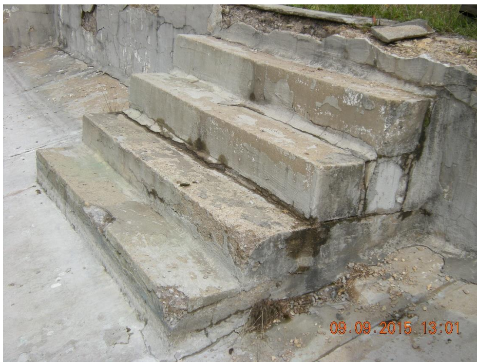
Obrázek 2.: Stav před opravou
