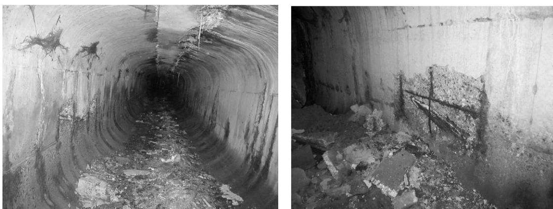
Obrázek 4.: Nulové krytí vložek v dutině mezi nosníky I-73, koroze zvedaných kabelů ve stojině nosníku
