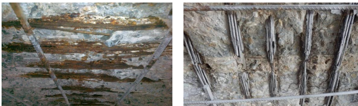
Obrázek 2.: Koroze kabelů ve spodní desce nosníku KA
