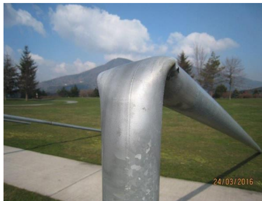
Obrázek 2.: Detail zlomeného sloupku. Zlomení v místě zesílení.
