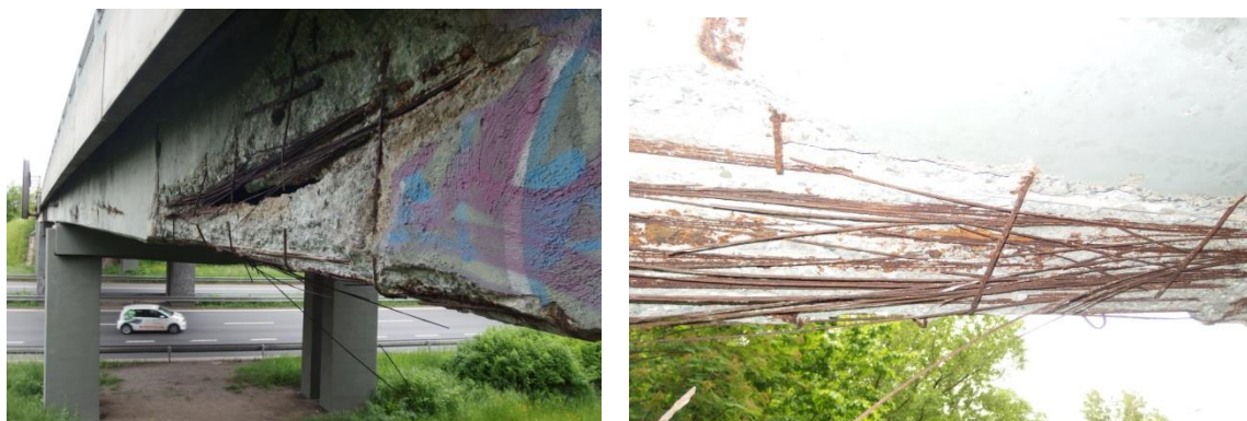
Obrázek 1.: Koroze zvedaných kabelů nosníku KA
