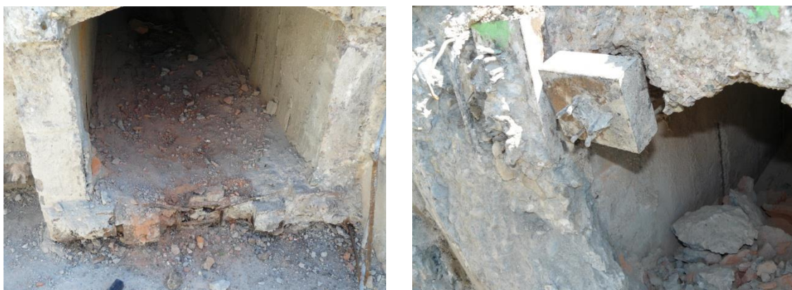
Obrázek 3.: Koroze betonu v kotevní oblasti, podrcený beton pod kotvou, její vybočení
