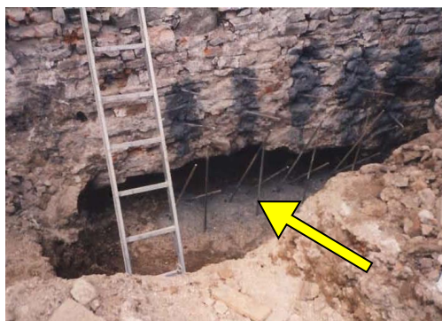
Obrázek 14.: Stav původního základů – mohutná kaverna pod dolní hranou základu (šipka).
