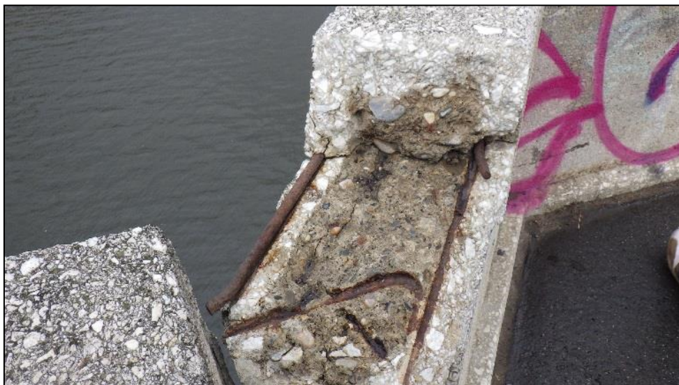
Obr.6: Detail porušeného madla zábradlí, dvouvrstvé provedení s nepravdělnou polohou hladké ocelové výztuže
