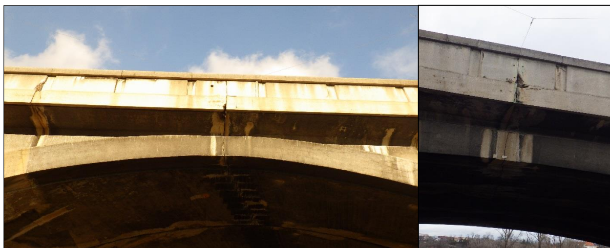
Obr.4: Příklady viditelného poklesu vrcholu oblouku s porušením římsy i zábradlí
