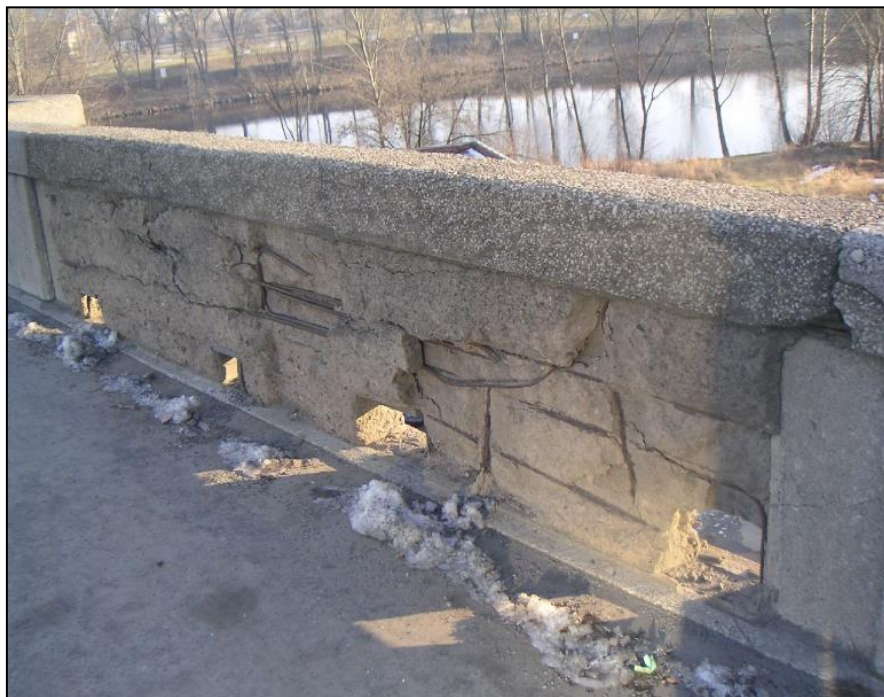
Obr.7: Stav vnitřní strany některých z výplní zábradlí mostu
