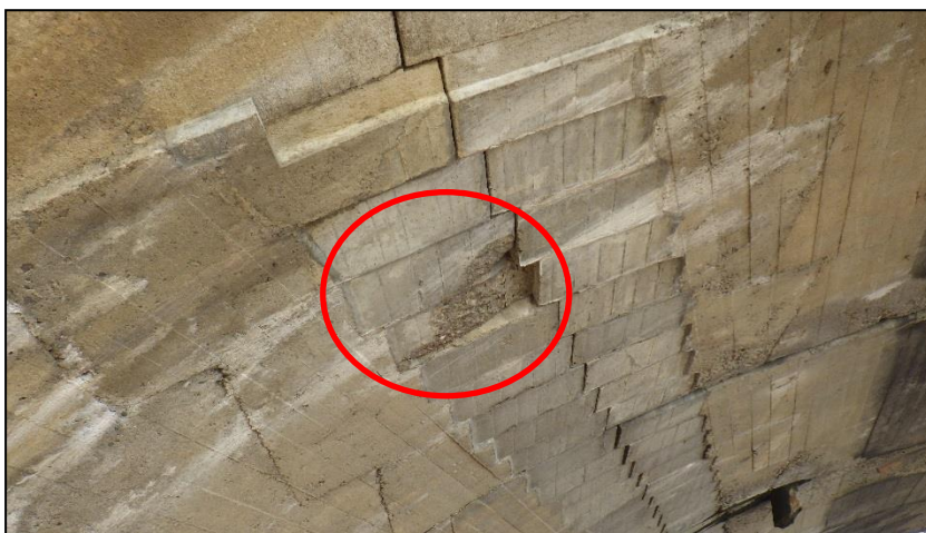
Obr.3: Lokální odštipnutí bloků patního kloubu druhého pole
