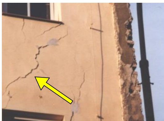
Obrázek 5.: Potrhání (šipka) uliční fasády při nezajištěném výkopu v proluce.
