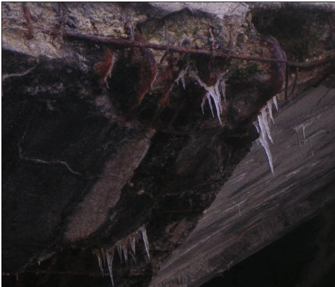
Obr.5: Stav podhledu mezipodesty a ramene schodiště v lomu monolitické desky
