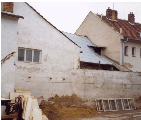
Obrázek 2.: Pohled na původní zchátralý dům ze dvora (viz Obr. 19).
